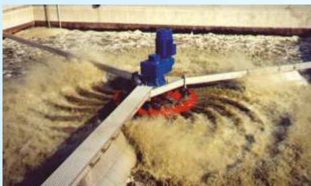
SBR-Kläranlage Gemeinde Krzyz, Polen
