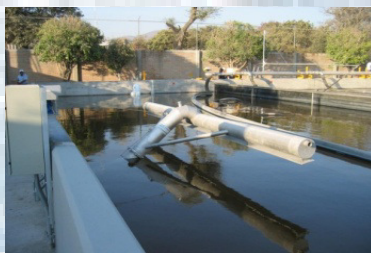
BSK®-Klarwasser-Dekanter einer Kläranlage in Mexiko
