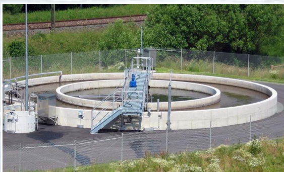
Kombibecken mit Bedienbrücke und lokales Pumpwerk (links)
