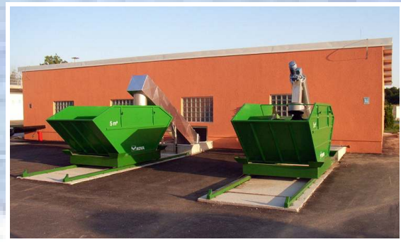
Abwurf von Sand und Feststoffen aus der Vorklärstation. Durch ein spezielles Waschverfahren wird ein Großteil der organischen Inhaltsstoffe in das Abwasser zurückgeführt.
