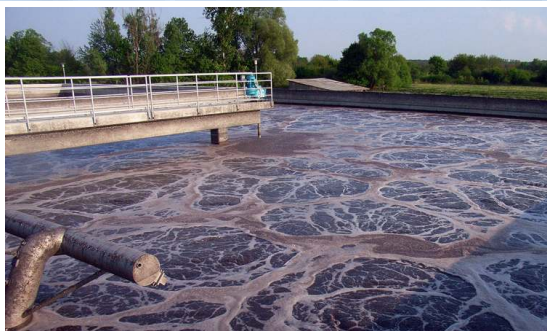
Blick auf einen der vier SB-Reaktoren mit zentral angeordnetem HyperClassic-Rührwerk und den BSK®-Dekanter zum Abzug des Klarwassers.
