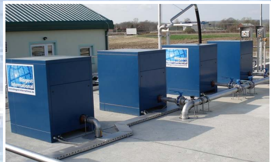
Vier Drehkolbenverdichter mit Verteilerleitung
