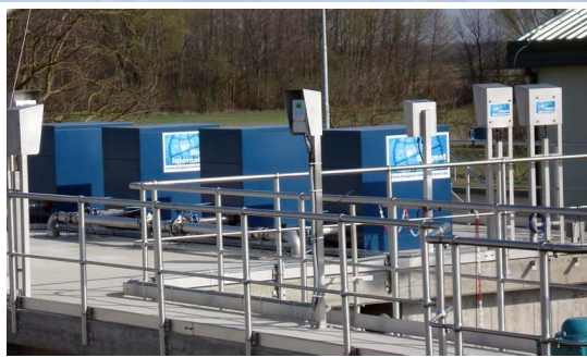
Bedienplattform mit Gebläsen und Messtechnik
