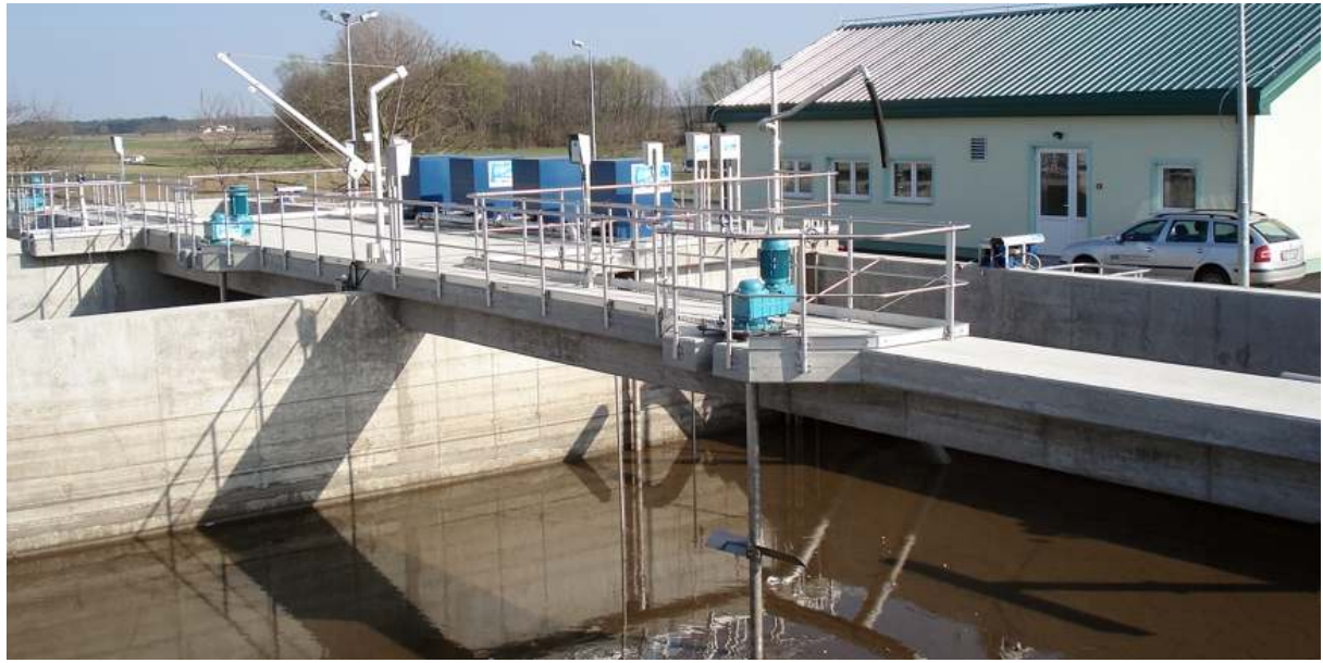
Blick auf die zentrale Anlagenplattform mit den vier Drehkolbengebläsen, im Hintergrund das Betriebsgebäude
