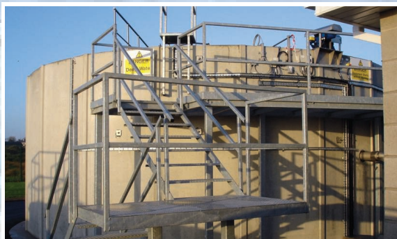
Bedienpodest für die Bedienung und Wartung der Anlage
