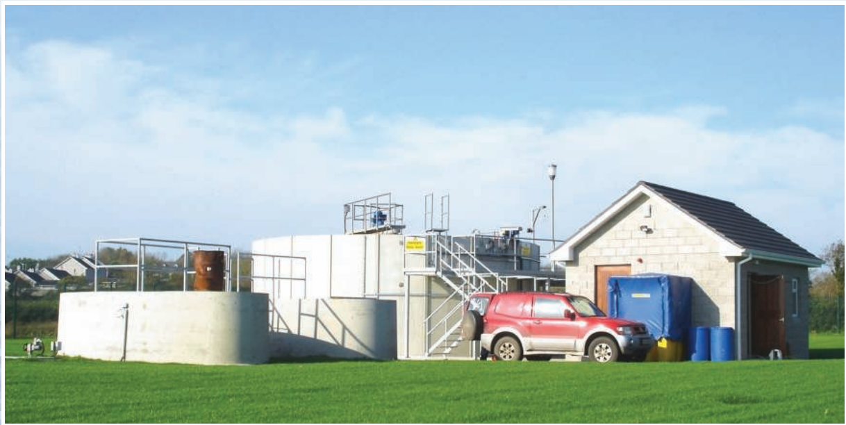
Ansicht der SBR-Anlage CARRIG ON BANNOW
