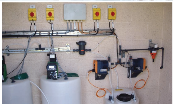
Dosieranlagen für BIOCELL und Chlor im Betriebsgebäude
