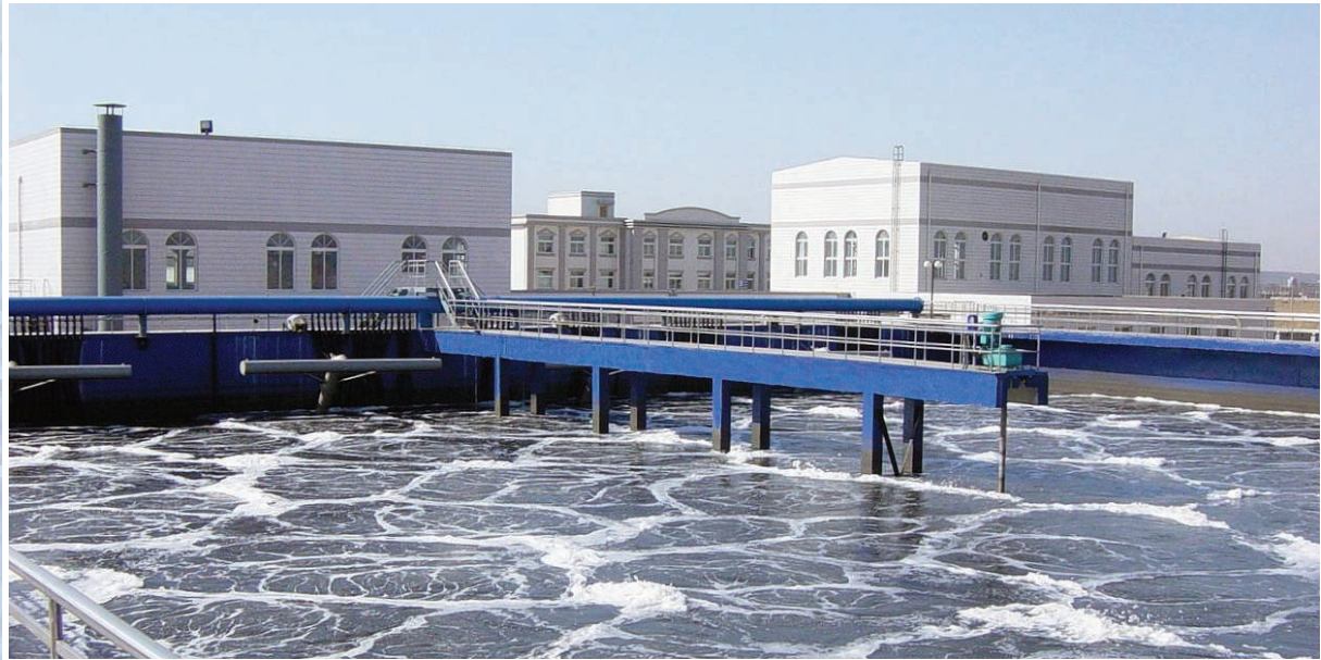
Biologischer Teil der Kläranlage HULUDAO (VR China)
