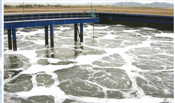
SBR-Reaktor während der Belüftungsphase
