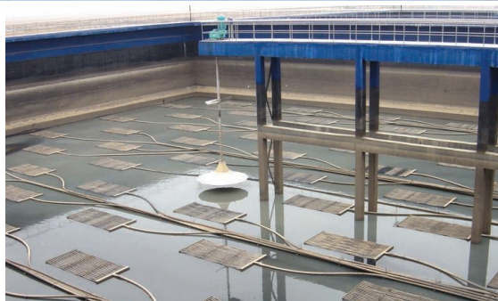
Montage des Belüftgitter (E-Flex-Module) und des Rührwerks
