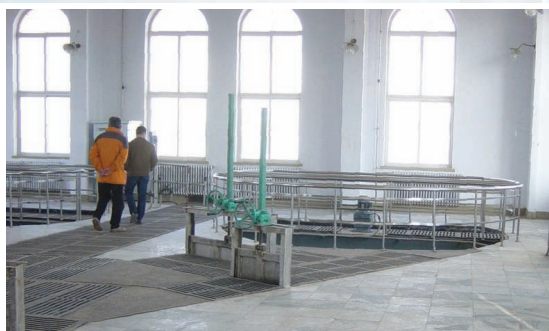
Maschinenhalle mit Zulaufschiebergruppe
