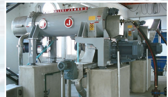
Hochleistungszentrifugen zur Schlammentwässerung
