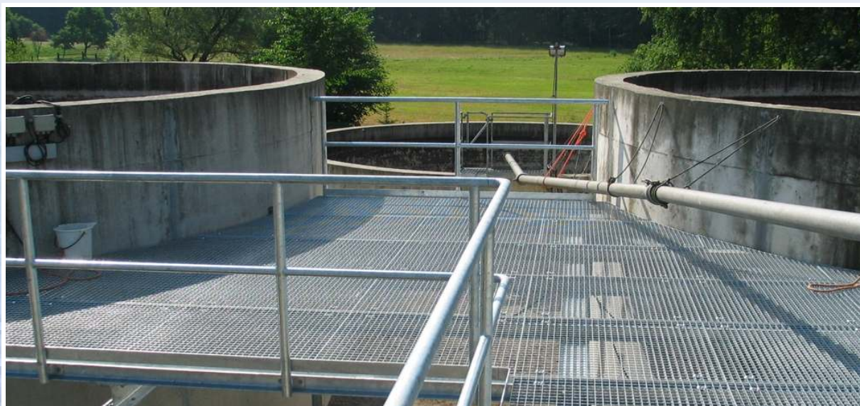
Blick auf die zentrale Anlagenplattform zur besseren Bedienung und Wartung der Kläranlage
