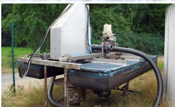
Ausgebautes altes und unwirtschaftliches Belüftungssystem
