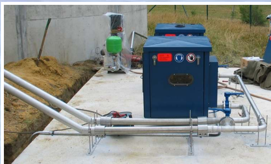
Zwei Drehkolbenverdichter zur Erzeugung der Druckluft
