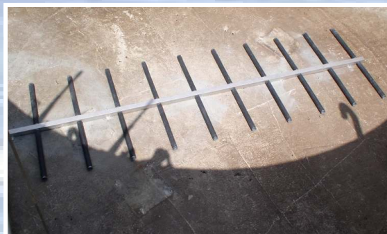
Auf dem Beckenboden installiertes Belüftergitter
