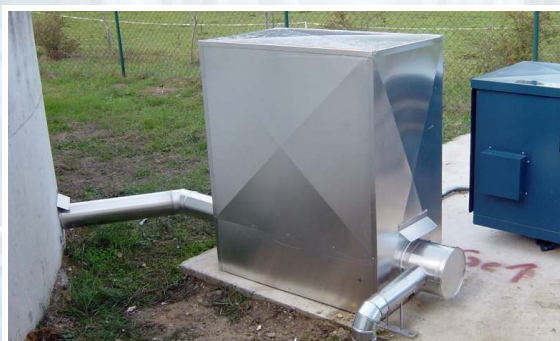
Brauchwasserpumpe mit Verkleidung (Frostschutz)
