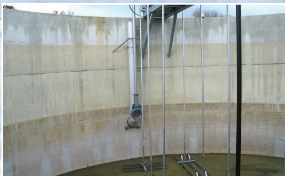
Dekantereinrichtung (elektr. Schieber mit Ab- und Überlaufrohr)
