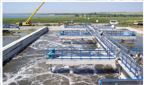
SB-Reaktor während der Belüftungsphase
