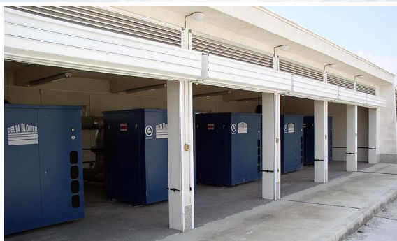
Gebläsestation mit 5 Drehkolbenverdichtern
