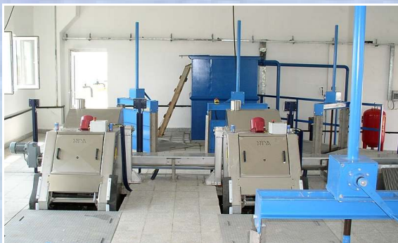
Zweistraßeige Stufenrechenanlage im Gebäude
