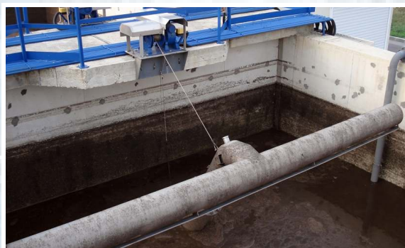
Klarwasserdekanter mit Elektro-Seilwinde
