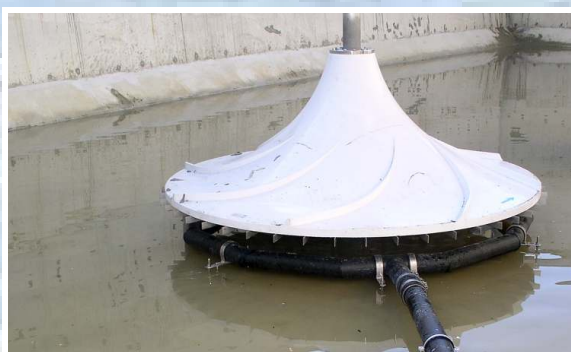
Rührwerkskörper mit darunterliegendem Begasungsring
