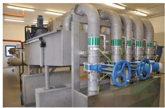
Vorklärstation (Flachfeinsiebrechen) mit Zulaufleitungen
