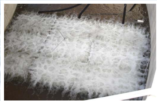
Blasenbild eines der eingesetzten E-Flex-Module
