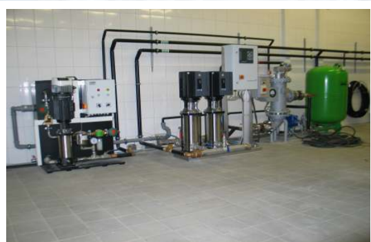
Brauchwasseranlage (Systemtrenner, Druckerhöhung, Filter)
