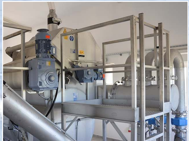
Der Rundfeinsiebrenner trennt die Feststoffe aus dem Kläranlagenzulauf. Diese werden in der Waschpresse gewaschen und verdichtet.
