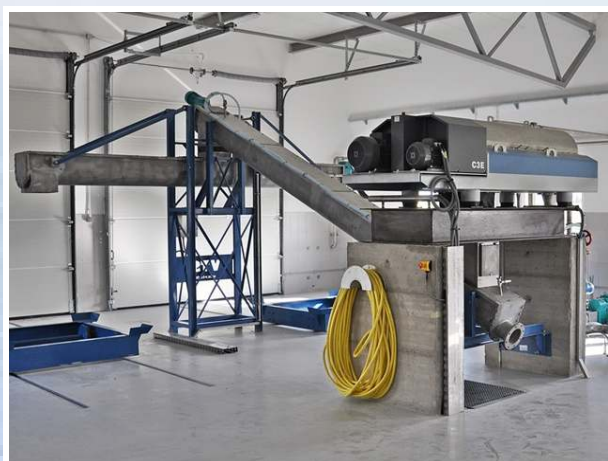
Schlammwässerungssystem: Hochleistungszentrifuge mit Förderschnecken für entwässerten Schlamm
