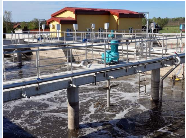
Blick auf den Wartungssteg eines SB-Reaktors mit dem Getriebemotor eines HyperClassic®-Rühr- und Begasungssystems
