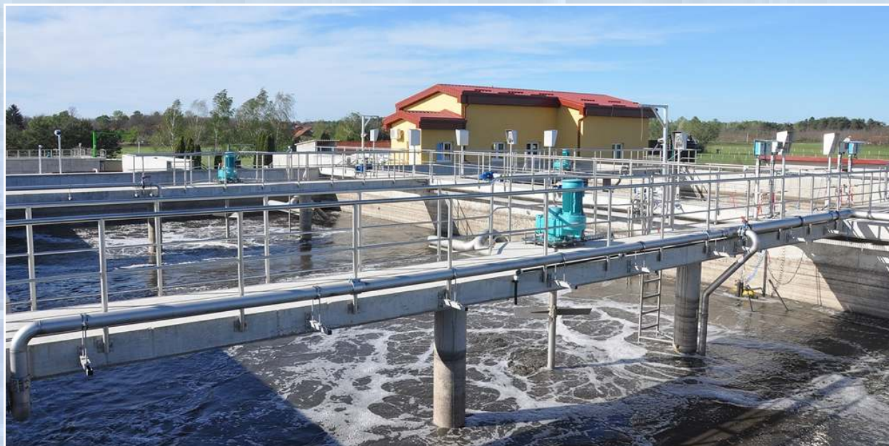
Biologischer Teil der Kläranlage DURDEVAC (Kroatien)
