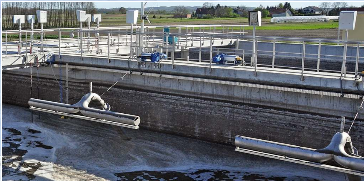
Klarwasserabzugssystem im SBR-Becken: BSK®-Dekanter mit Elektroseilwinden
