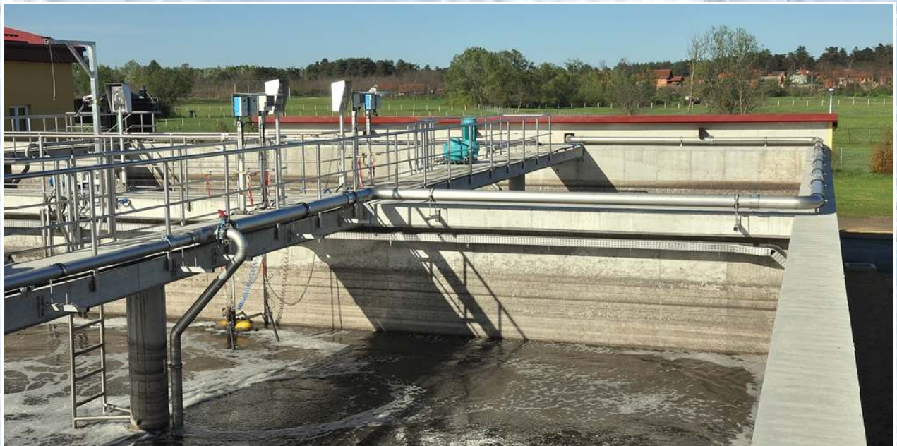
Blick auf die SB-Reaktoren
