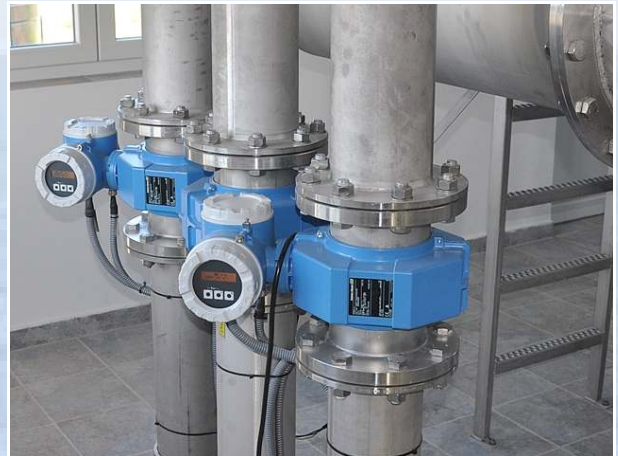
Die Zulaufmengenmesser (magnetisch-induktiv) ermitteln die Quantität jeder einzelnen Zulaufleitung.
