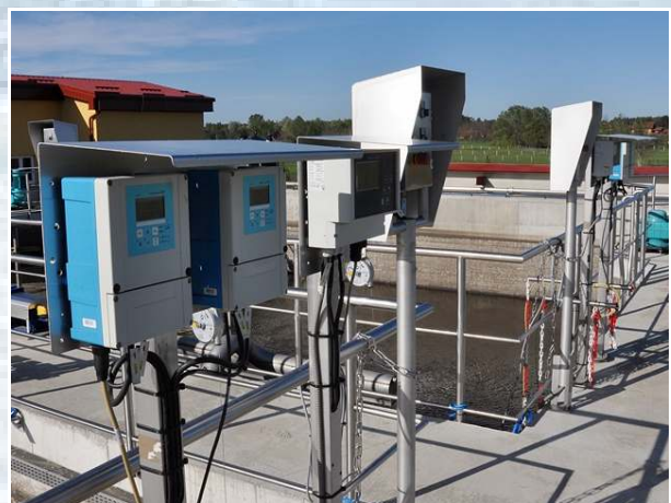
Messtechnik und Vorortschaltstellen
