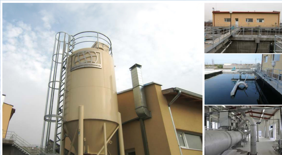
Biologische Kläranlage für die bulgarische Stadt Svilengrad
