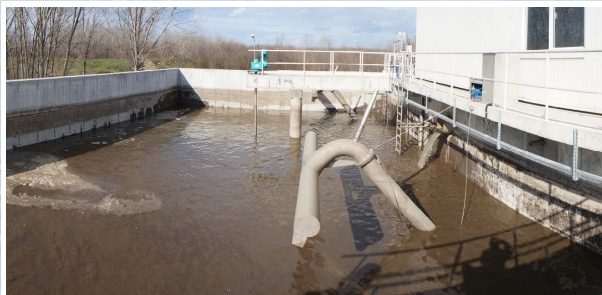
SB-Reaktor 1 der Kläranlage Kozlodui in der Füllphase
