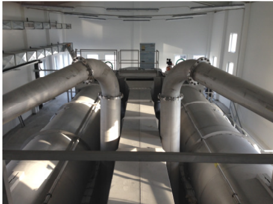
Zwei-straßige kompakte Vorklärstation, komplett aus Edelstahl hergestellt, einschließlich leistungsfähigem Walzensandfang
