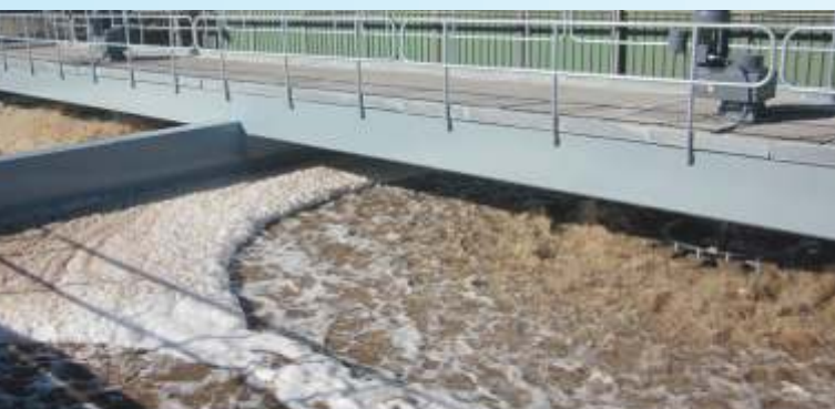
Station d'épuration d'une usine de papier en Espagne
