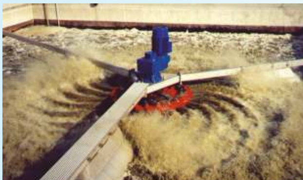
Station d'épuration SBR de la commune de Krzyz, Pologne
