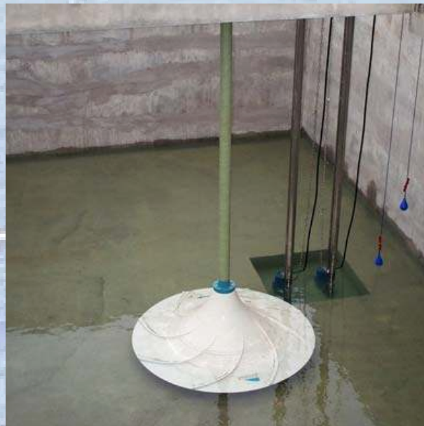
Slika br. 9: HYPERCLASSIC® - sustav za miješanje koji je instaliran u industrijskom međuspremniku ispred pogona za pročišćavanje otpadne vode jedne velike tvornice za bojanje tkanine u Maroku. Planiranje i tehničku opremu izradila je tvrtka Biogest International GmbH .
