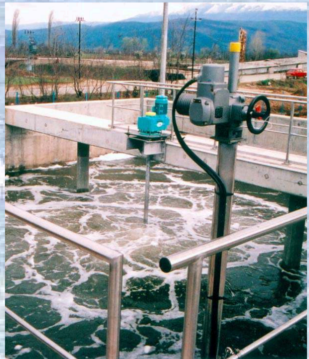
Slika br. 6: HYPERCLASSIC ® -sustav za ventilaciju u SBR-pogonu za pročišćavanje otpadnih voda koji je izrađen od strane Biogest International GmbH za SEE-fakultet grada Tetovo (Makedonija) po sistemu "ključ u ruke".
