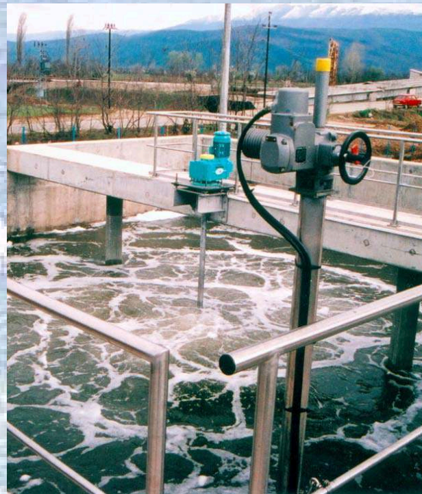
Slika br. 6: HYPERCLASSIC®-sustav za ventilaciju u SBR-pogonu za pročišćavanje otpadnih voda koji je izrađen od strane Biogest International GmbH za SEE-fakultet grada Tetovo (Makedonija) po sistemu "ključ u ruke".
