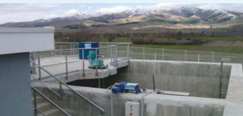
SBR-Kläranlage der Tabakfabrik Bitola (Mazedonien)
