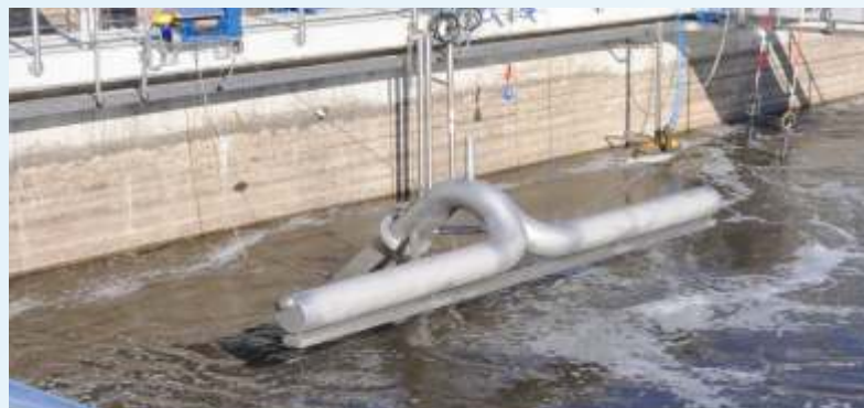
BSK®-Dekanter Kläranlage Durdevac (Kroatien)
