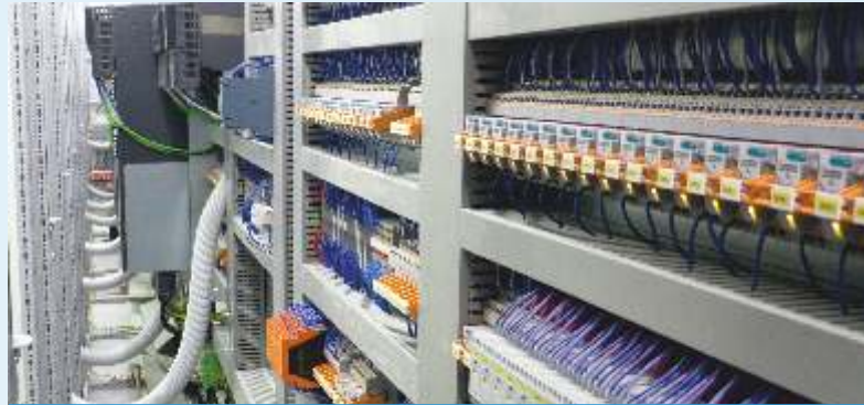
Innenansicht eines Schaltschranks der Kläranlage
