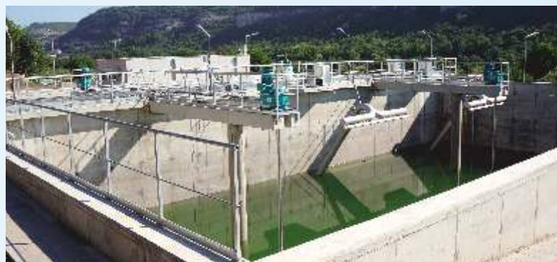
SBR-Kläranlage der Gemeinde Provadia (Bulgarien)
