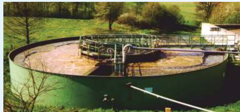
KA der Tierkörperbeseitigungsanstalt Detmold (Deutschland)
