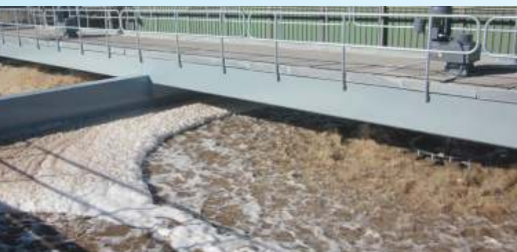
Hệ thống xử lý nước thải cho một nhà máy giấy ở Tây Ban Nha
