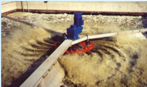
Tua-bin BSK® sục khí bề mặt lắp nổi (Nhà máy xử lý nước thải Krzyz-Ba Lan)
