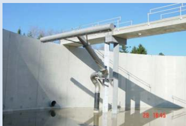
BSK®-Dekanter installiert in einer Kläranlage bei Basel (Schweiz)
