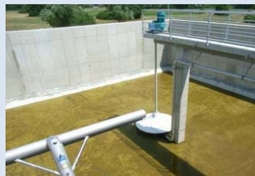
HyperClassic-Begasungssystem installiert auf einer Betonbrücke. Im Vordergrund befindet sich ein BSK®-Dekanter.
