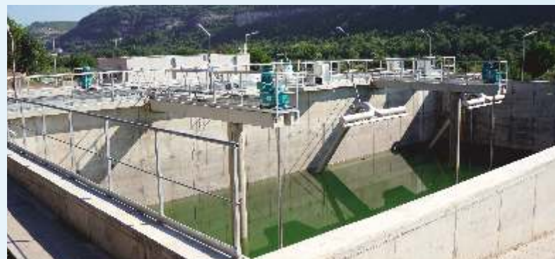
SBR-WWTP of Provadia (Bulgaria)
