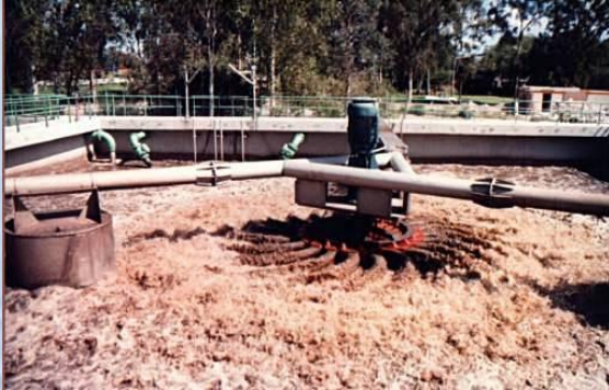
Kläranlage der mexikanischen Stadt Aguascalientes (20.000 EW)
