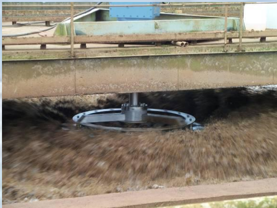
SBR-Kläranlage für die deutsche Stadt Körkwitz (40.000 EW)
