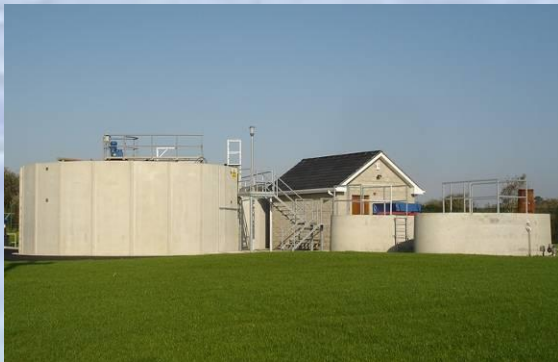
SBR-Kläranlage der irischen Gemeinde Carrig on Bannow (1.000 EW)
