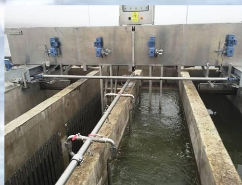
Kläranlage der rumänischen Gemeinde Pechea (16.000 EW)
