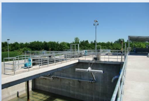
SBR-Kläranlage für die serbische Stadt Rumenka (8.000 EW)
