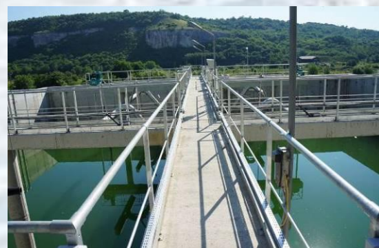
SBR-WWTP für die bulgarische Stadt Provadia 15.000 EW
