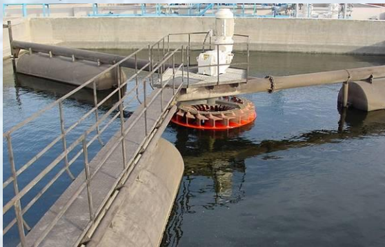
Kläranlage der ägyptischen Stadt Amreya bei Kairo (50.000 EW)
