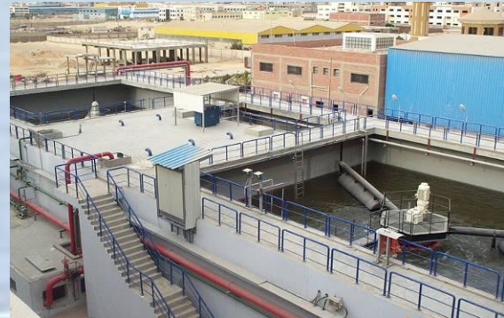
Industrie-Kläranlage des CMC-Projektes bei Kairo. 2-straßige SBR-Kläranlage mit schwimmender Turbine
