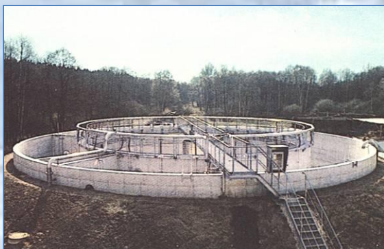
Kläranlage der bayerischen Stadt Vilseck (6.000 EW)
