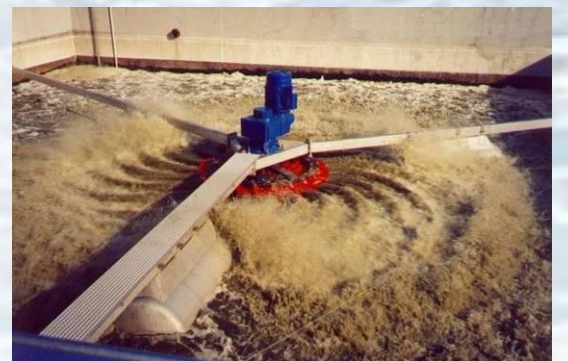
SBR-Kläranlage der polnischen Gemeinde Krzyz (7.000 EW)
