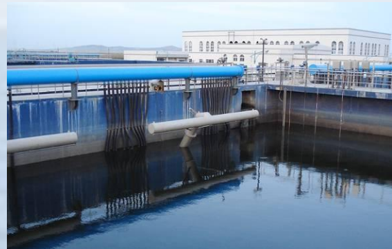
Kläranlage der chinesischen Stadt Huludao (100.000 EW)
