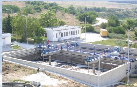
SBR-Kläranlage der bulgarischen Stadt Beloslav Anschlusswert: 12.000 EW
