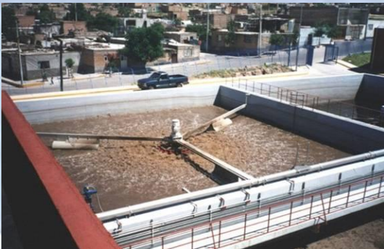
Kläranlage für die BOSCH AG Toluca Mexiko (2.000 EW)
