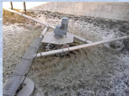
SBR-Kläranlage für die mexikanische Stadt Morelos (15.000 EW)
