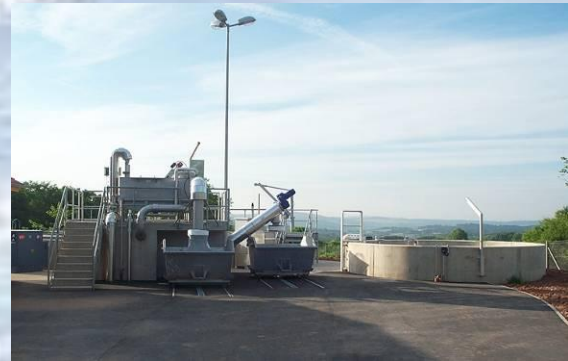
Kläranlage der deutschen Gemeinde Steinberg-Deckenhardt (1.000 EW)
