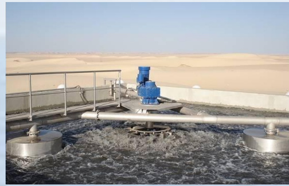
SBR-Kläranlage in Libyen
