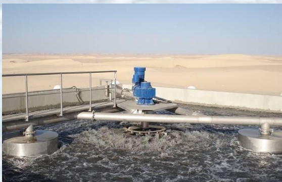
SBR-Kläranlage in Libyen
