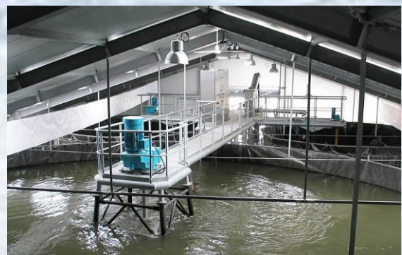
Kläranlage (SBR) für Camp Warehouse der ISAF in Kabul, Afghanistan (3.000 EW)
