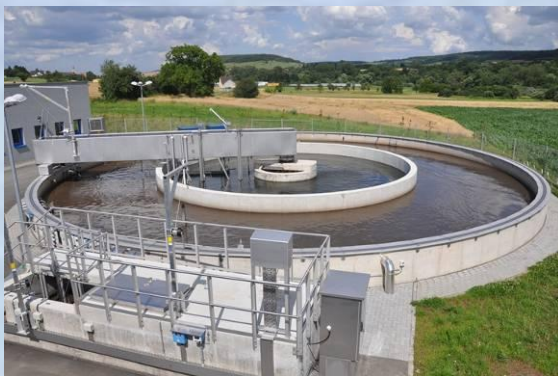
Kläranlage der Gemeinde Gersheim (4.500 EW)
