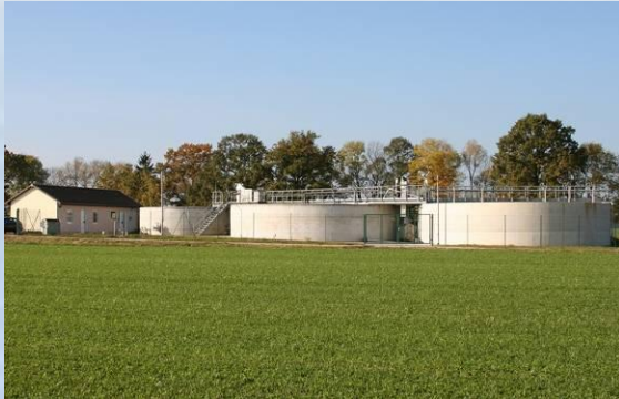
SBR-Kläranlage der deutschen Gemeinde Guttau (4.500 EW)
