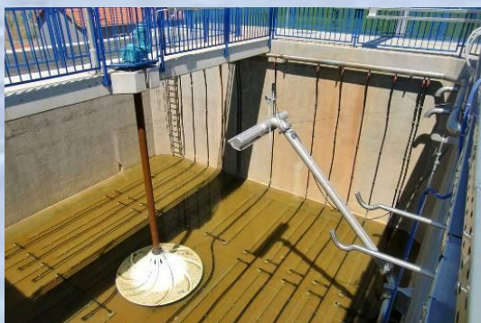
SBR-Kläranlage für die serbische Stadt Stepanovicevo (2.000 EW )
