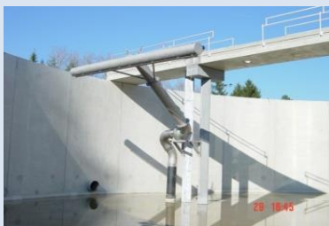
BSK®-Dekanter installiert in einer Kläranlage bei Basel (Schweiz)
