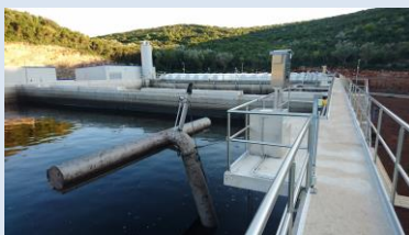
BSK®-Klarwasser-Dekanter einer Kläranlage in Rumänien
